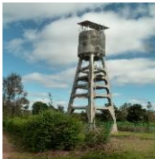
Château d'eau réservoir 25 M3
