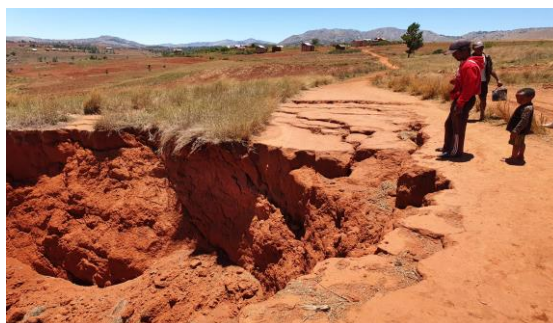
Sous les pieds de Frédéric les canalisations de réseau d'eau
