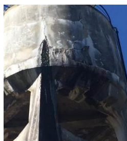
Fissures du réservoir
